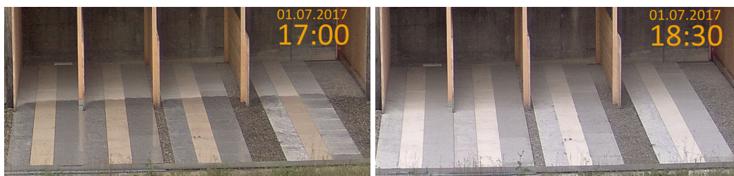
Abbildung 9: Austrocknung der vier Aufbauten zur Verhinderung von Feuchtflecken nach einem Niederschlag im Sommer. Der Niederschlag endet um 17.00 Uhr. In diesem Fall sind die Beläge nach etwa 1.5 Stunden wieder trocken.
