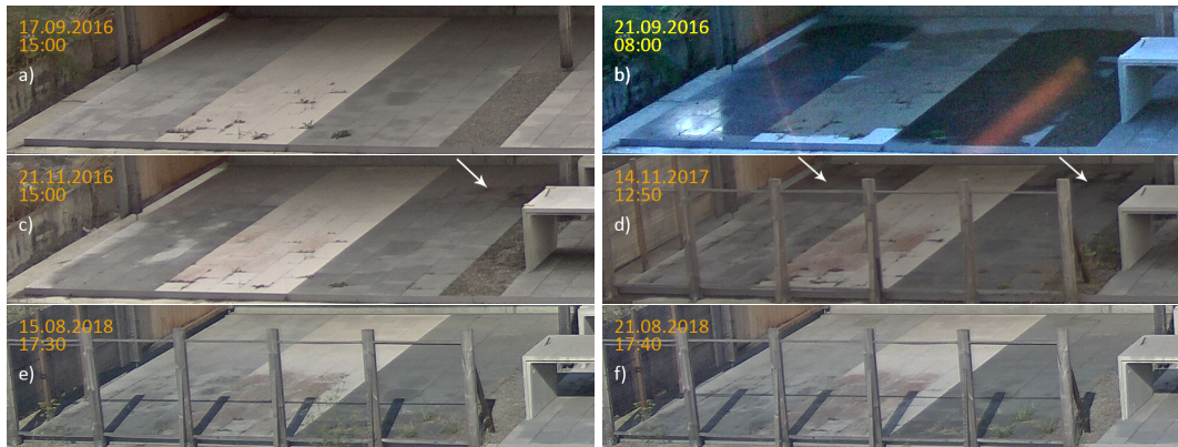
Abbildung 7: Entwicklung der Feuchtflecken nach der Besprühung mit einer Salzlösung (ca. 1 g Salz pro Quadratmeter Belag; Hauptbestandteile: Kalium, Natrium, Kalzium, Magnesium, Chlorid, Sulfat) auf Feld 1. Das Photo am 17. September 2016 (a) wurde vor der Besprühung gemacht. Die Bereiche unter Dach sind im Allgemeinen trocken und ohne Flecken. Das Photo vom 21. September 2016 (b) zeigt die Anlage kurz nach der Besprühung. c) Die ersten Feuchtflecken unter Dach (weisse Pfeile) erscheinen etwa 2 Monate nach der Besprühung. Seither sind etliche Feuchtflecken auf den Gneis- und auf den Granitplatten unter Dach immer sichtbar (d). e,f) Die Feuchtflecken sind bei der Wärme in Sommer 2018 nicht mehr zu beobachten, erscheinen aber wieder Ende August.
